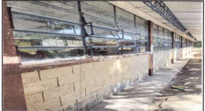
Foto 2: Ventanas-Sustrucción de vidrios
